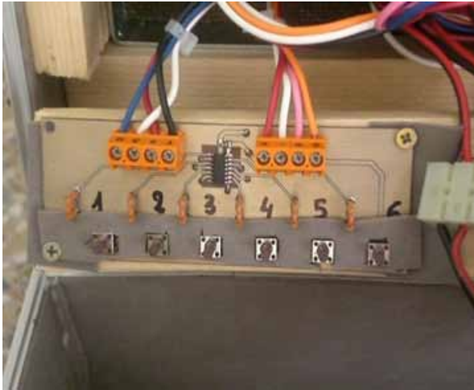
Figura 5: pulsantiera comandi manuali
